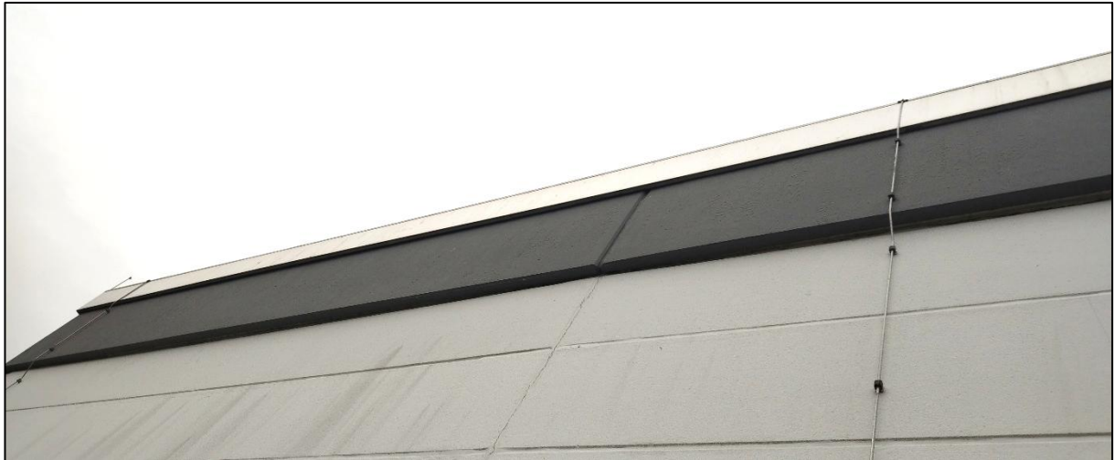
Abb. 4-6: Hauptdach mit wenig Spalten oder Löchern. Die Spalten der Metallprofile sind verschlossen
