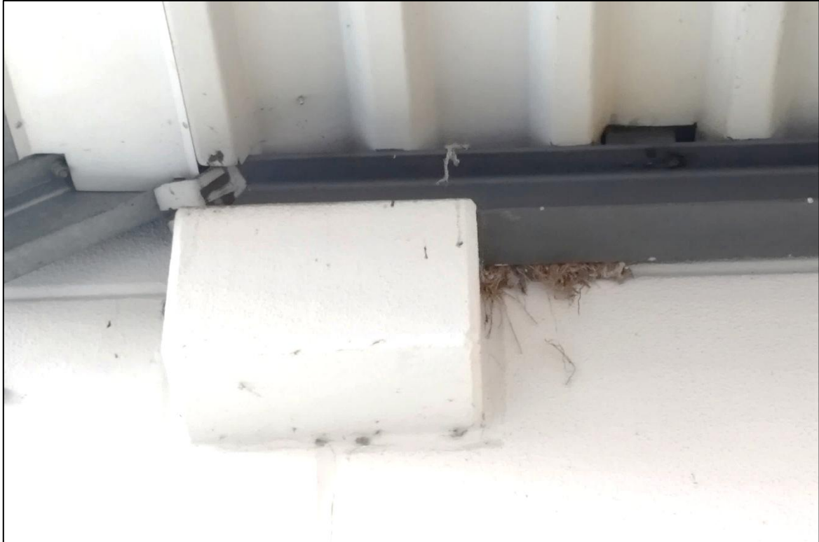
Abb. 4-2: Nistmaterial zwischen Balken und Wand (Vordach)
